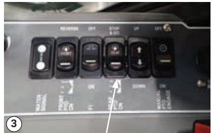
Zadný vývodový hriadeľ je zapnutý
